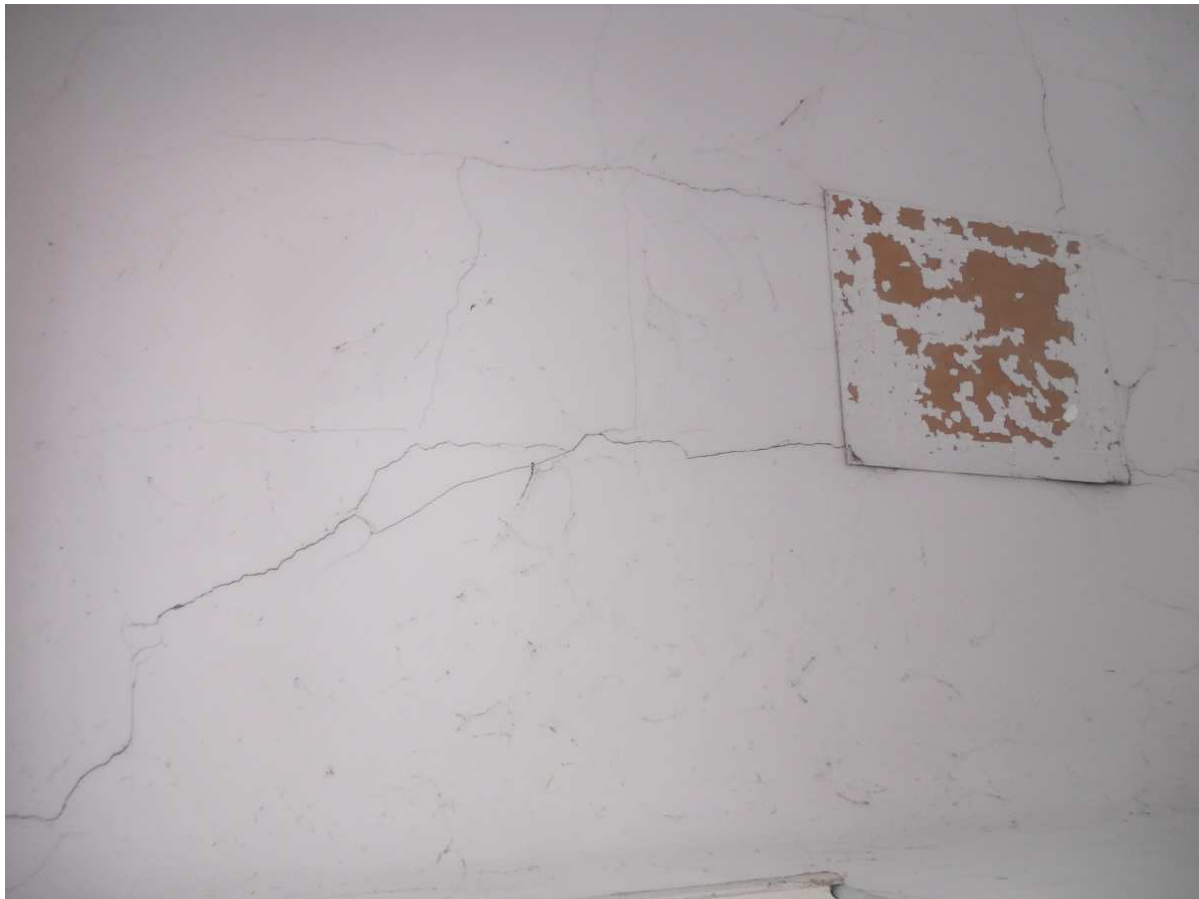
Foto n.13 Filature e fessurazioni all'intradosso del controsoffitto
