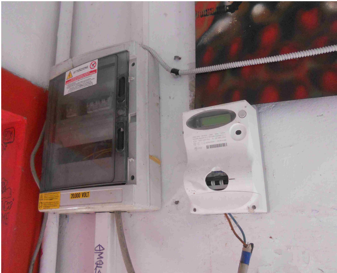
Foto n.15 Impianto elettrico – quadro e contatore
