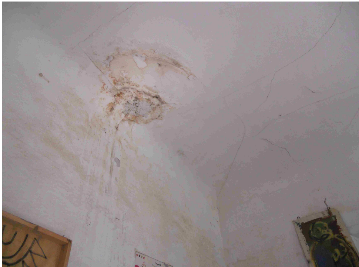
Foto n.14 Infiltrazioni d'acqua e fessurazioni del controsoffitto
