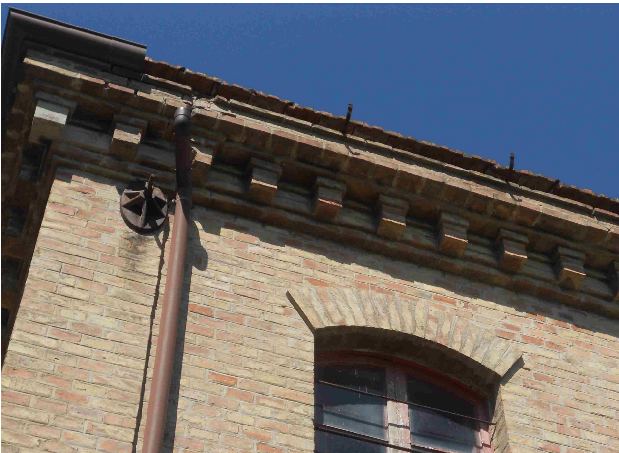
Foto n.2 Facciata est-particolare cornicione con assenza canale di gronda
