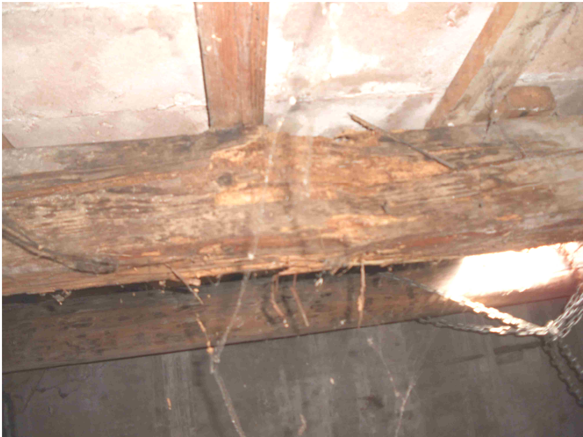
Foto n.23 Sottotetto – particolare trave danneggiata
